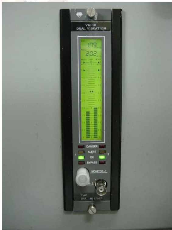
Detalhe de instalação do monitor de vibração modelo VM5 e acesso para programação do sistema de monitoração de vibração
