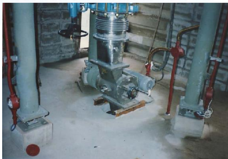
Detalhe de instalação do sensor
