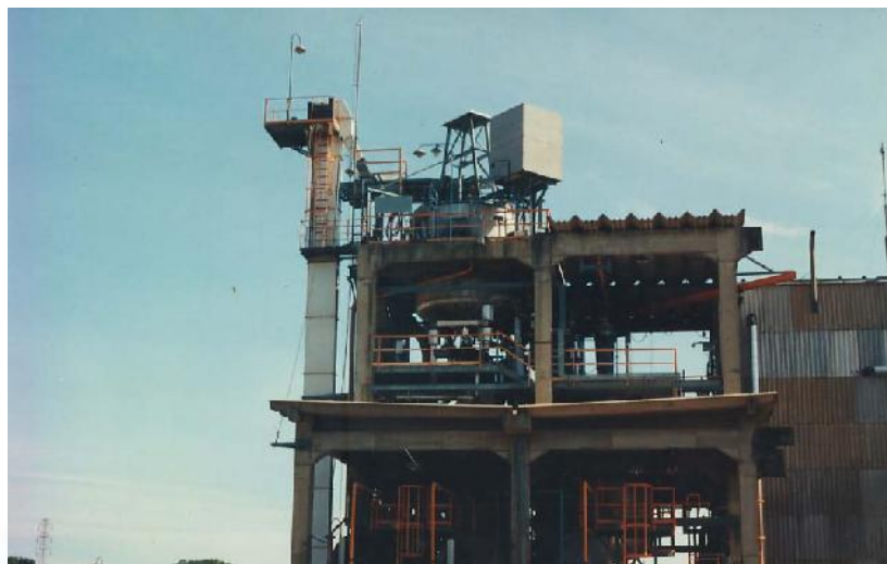
Vista Geral do Reator
