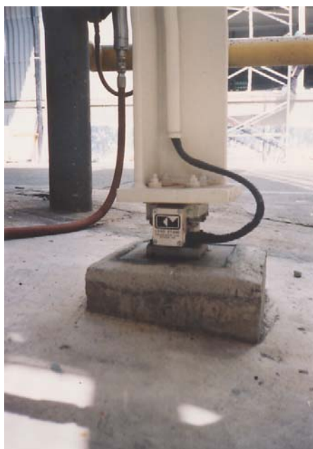
Detalhe de instalação dos sensores
