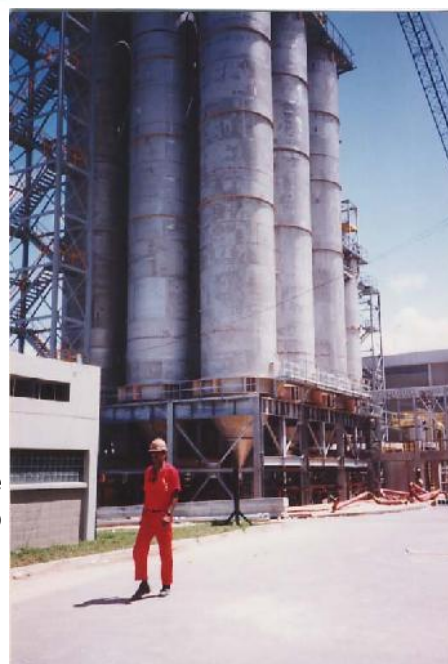
Vista final do parque instalado
