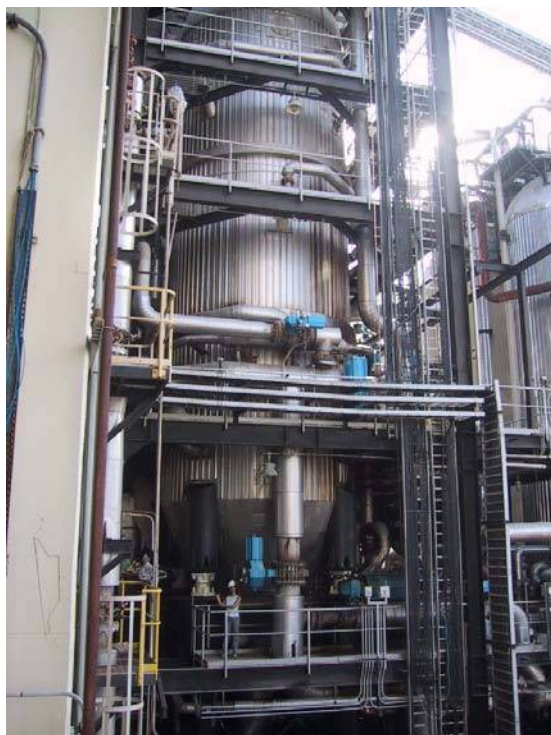
Vista Geral do Digestor
