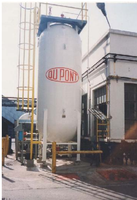
Vista Geral do Tanque
