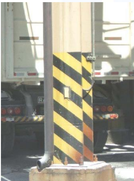
Detalhe de instalação do sensor na viga de sustentação. Sem necessidade de modificação estrutural
